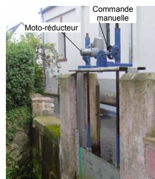
Vanne à commande électrique et manuelle
