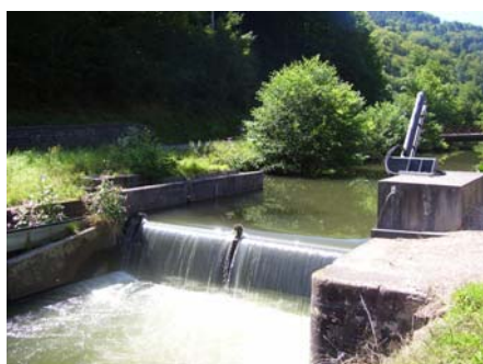
Vanne clapet sur la Zorn (67)
