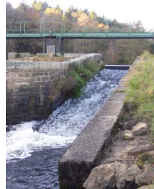
Passe de dévalaison et à canoës sur le Blavet (56).
