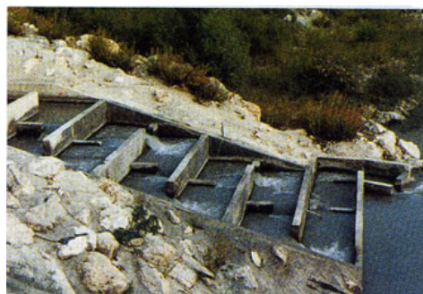
Passage à poissons à bassins successifs
