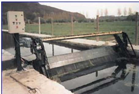
Dégrilleur à chaîne
